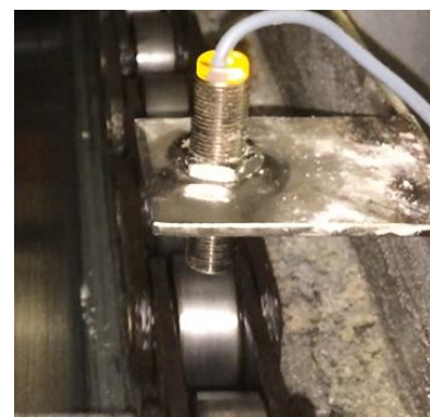
Détection de la position de la chaîne par un capteur inductif
