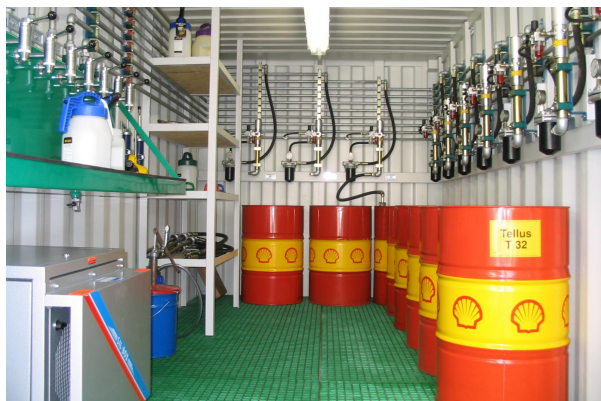
Bac de stockage LUSTOR avec aspiration, distribution et filtration des huiles
